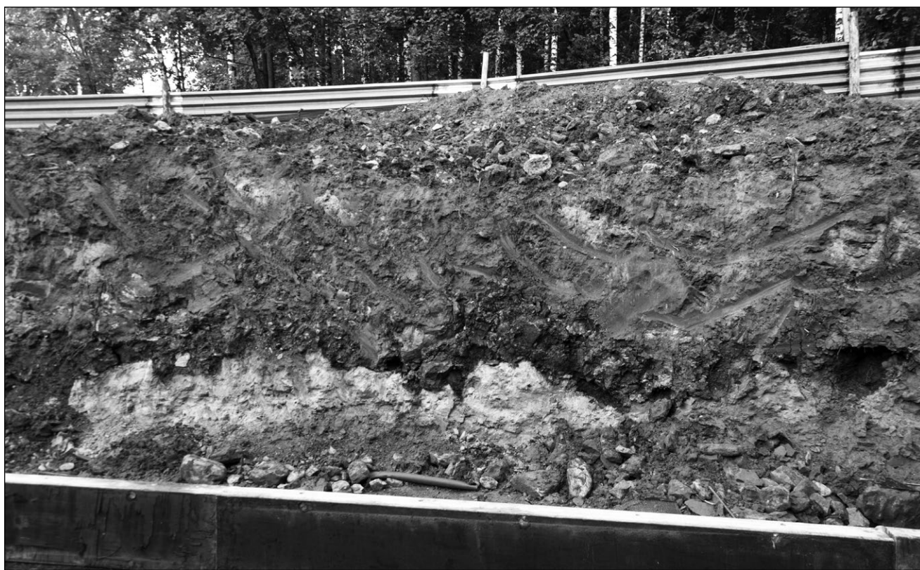
Рис. 2. Стенка строительного котлована на пересечении улиц Поселковой и Дружбы г. Ногинска. В стенке вскрыты верхнекаменноугольные доломиты (светло-серый цвет) с эрозийной поверхностью со следами выщелачивания, перекрытые четвертичными флювиогляциальными отложениями (темно-серый цвет) мощностью до 2.5 м, на которых лежит строительный мусор.
