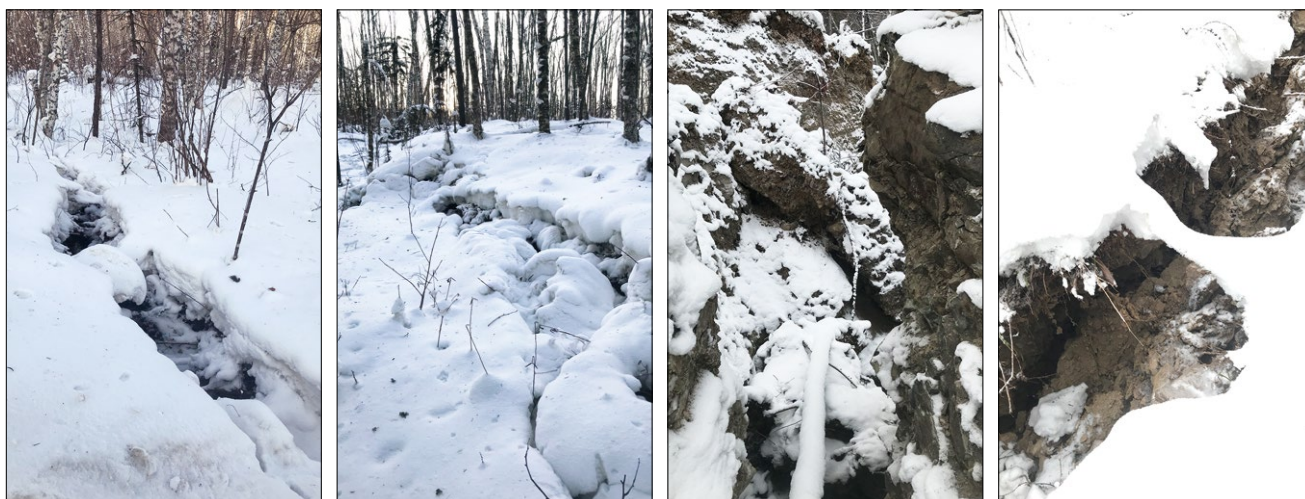
Рис. 5. Морозобойные трещины на участке выше стенки срыва оползня (фото И.А. Ковтуна).
