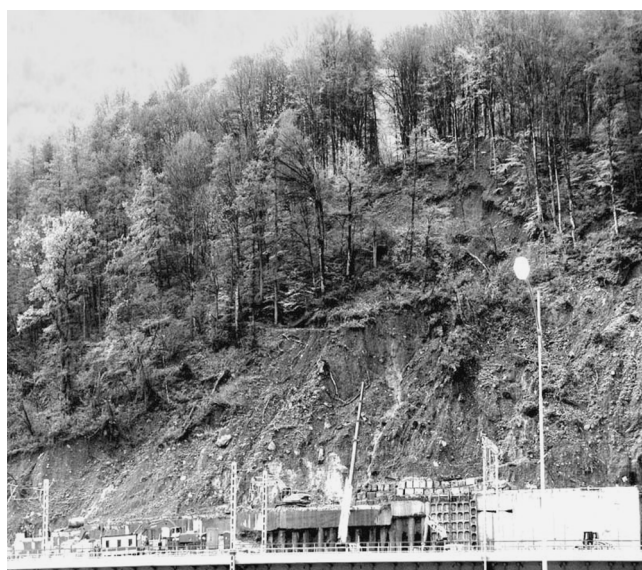
Рис. 2. Оползень (ПК-1 – ПК-4 автодороги на СТК “Горная Карусель”), спровоцированный подрезкой склона.
