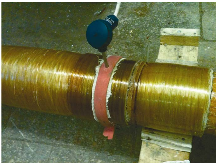
Рис. 6. Внешняя поверхность оболочки из стекловолокна, закрывающей соединительную муфту НКТ
