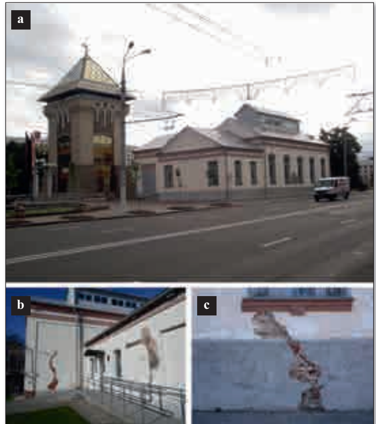
Рис. 9. Здание первой в Витебске электростанции (1897–1898 гг.) на проспекте Фрунзе в исторической части города (а) и трещины в стеновых конструкциях, образовавшиеся в результате вибрации при движении городского транспорта (май 2016 г.) (б, с) [9, 12]
