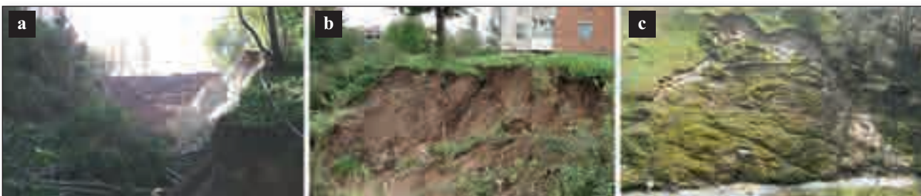
Рис. 6. Оползни на территории Витебска: a — срезания (левый склон оврага Дунай по ул. Правды, август 2006 г.); b — выдавливания (левый склон оврага Гапеевский по Московскому проспекту, август 2006 г.); c — поток (левый склон оврага Гапеевский по Московскому проспекту, апрель 2008 г.). Фото А.Н. Галкина
